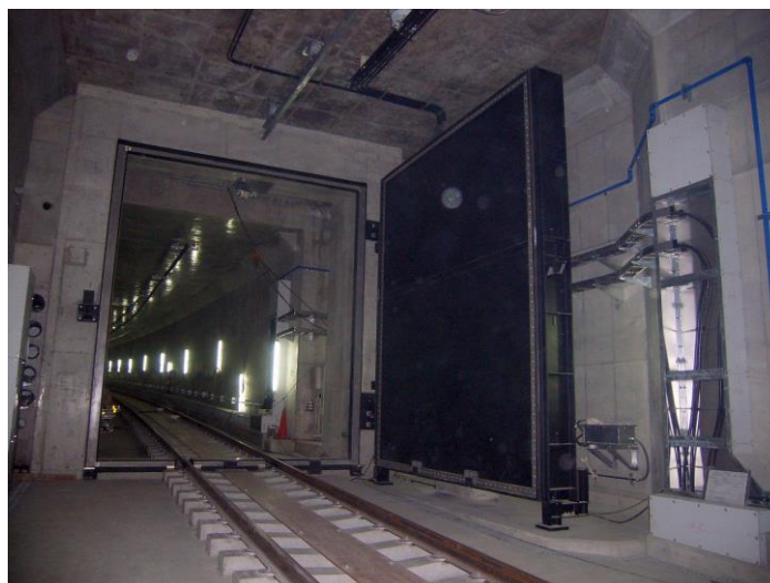
止水鉄扉設置状況（天満橋駅西側）
