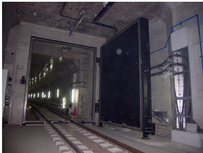
止水鉄扉設置状況（天満橋駅西側）
