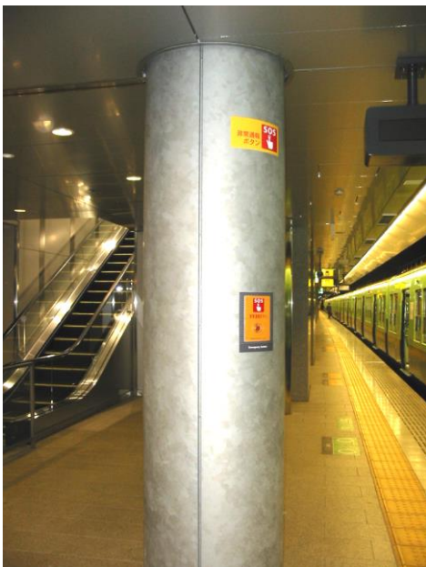
ホーム異常通報装置
