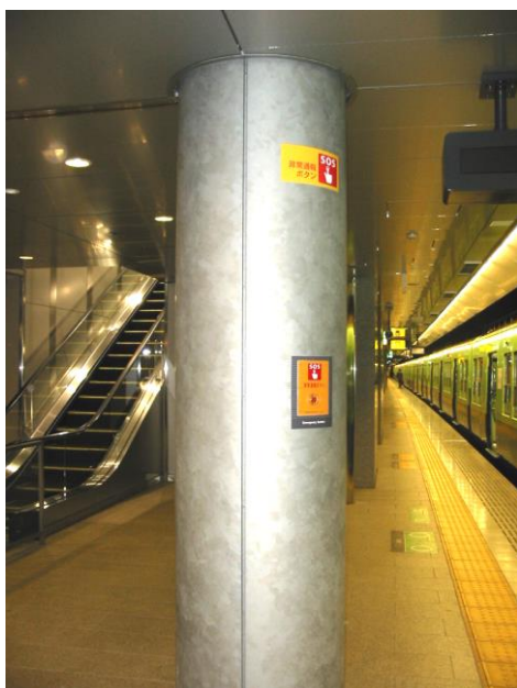
ホーム異常通報装置
