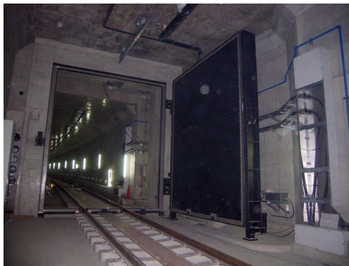
止水鉄扉設置状況（天満橋駅西側）
