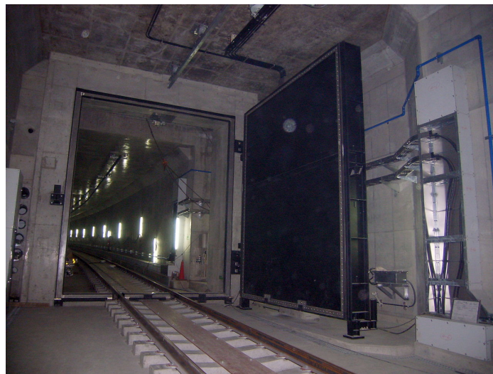
止水鉄扉設置状況（天満橋駅西側）
