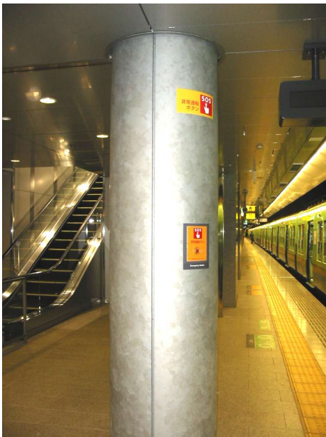
ホーム異常通報装置
