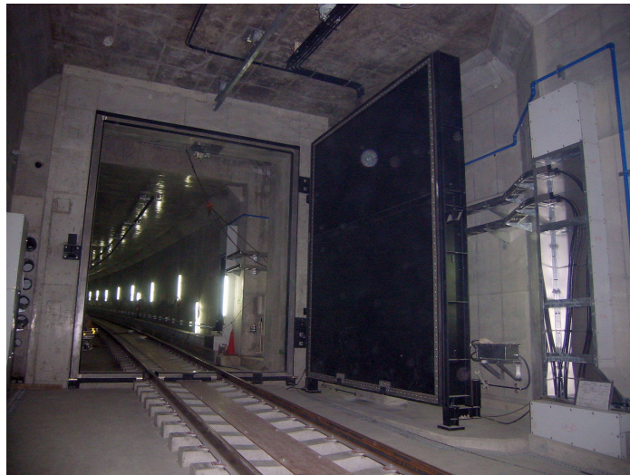
止水鉄扉設置状況（天満橋駅西側）
