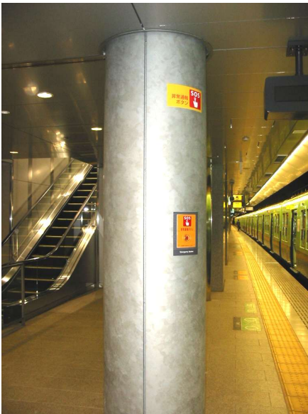
ホーム異常通報装置
